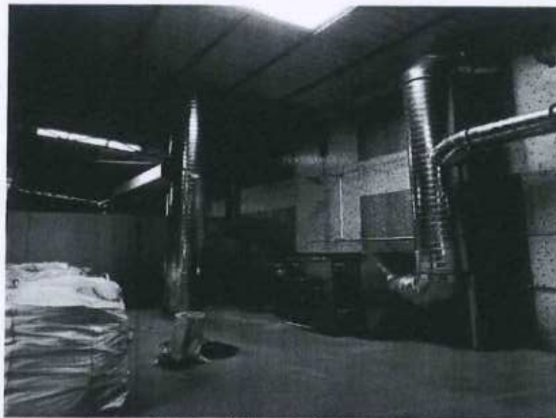
图 4-2 注塑、吹塑工序废气处理设施图
