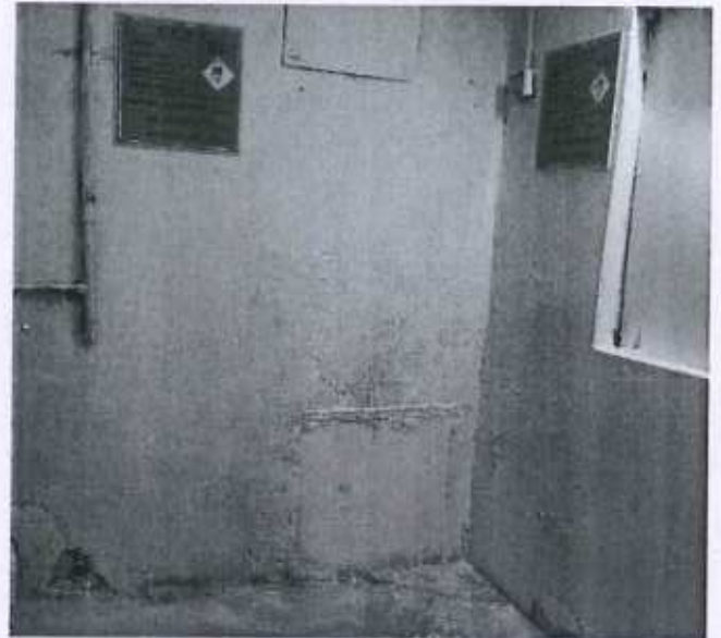
图 4-6 危废房内部图
