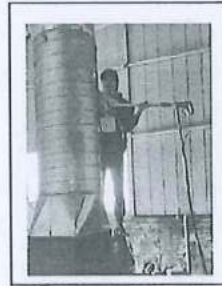
激光切割、印花、烘干工序废气排放口
