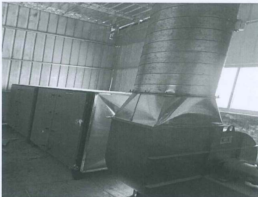
图 4.2 废气治理设施现场图
