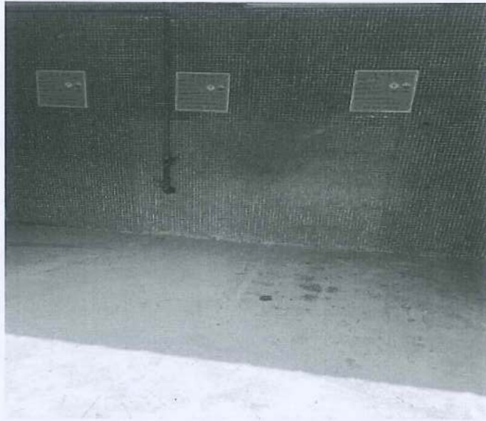
4.4 危废房内部图
