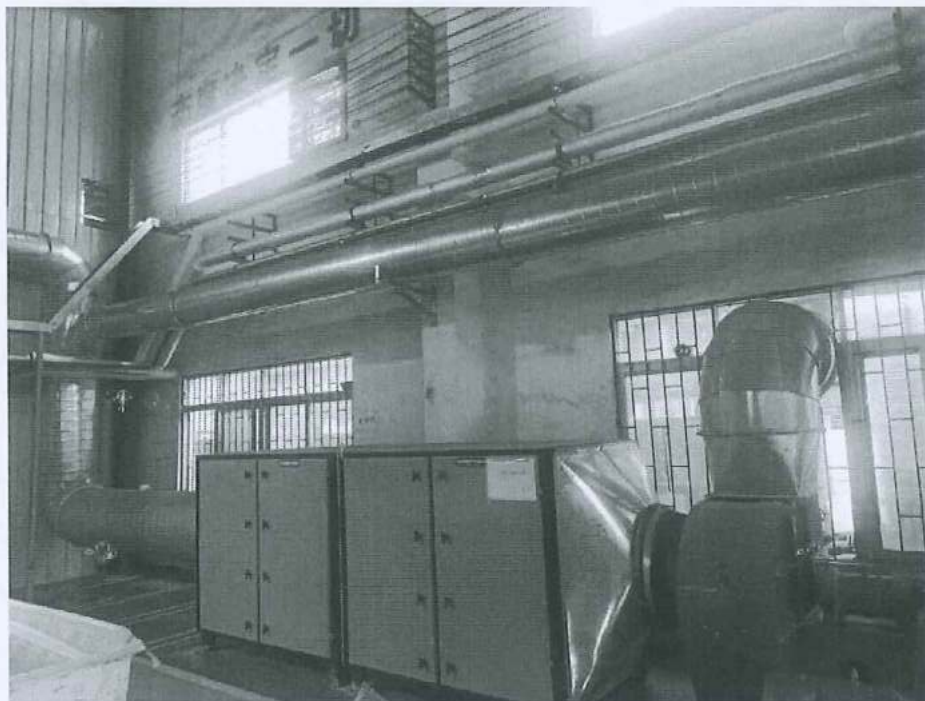
图 4.2 注塑废气治理设施图
