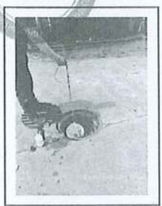
生活污水排放口
