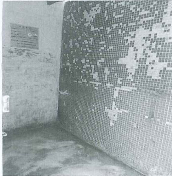
图 4.5 危废房内部图
