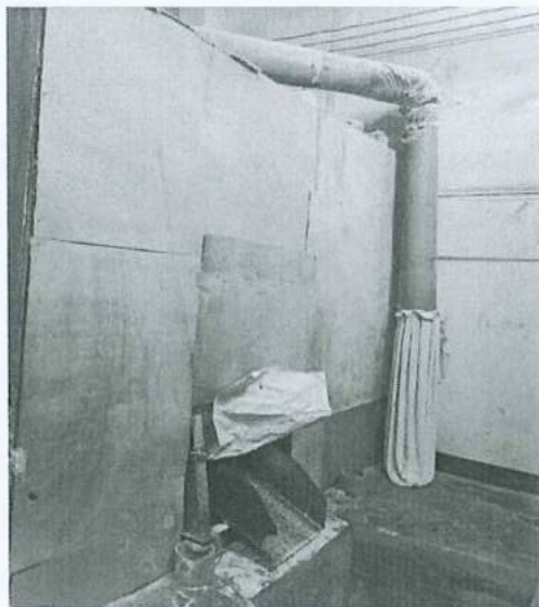
图 4.4 破碎粉尘治理设施图
