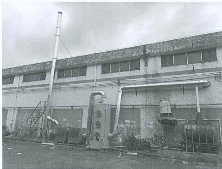
图 4.1 挤出废气治理设施图
