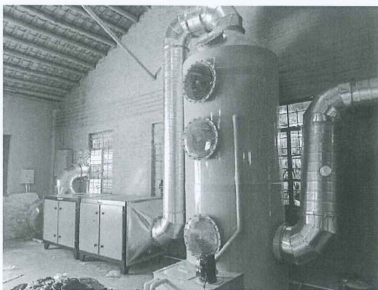
图 4.2 挤出废气治理设施图
