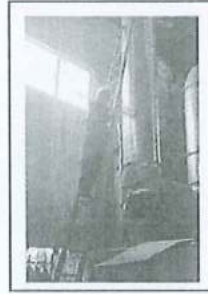
熔铝、浇注工序 废气排放口
