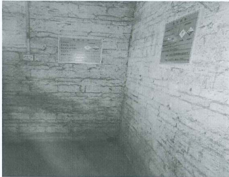
图 4.6 危废房内部图
