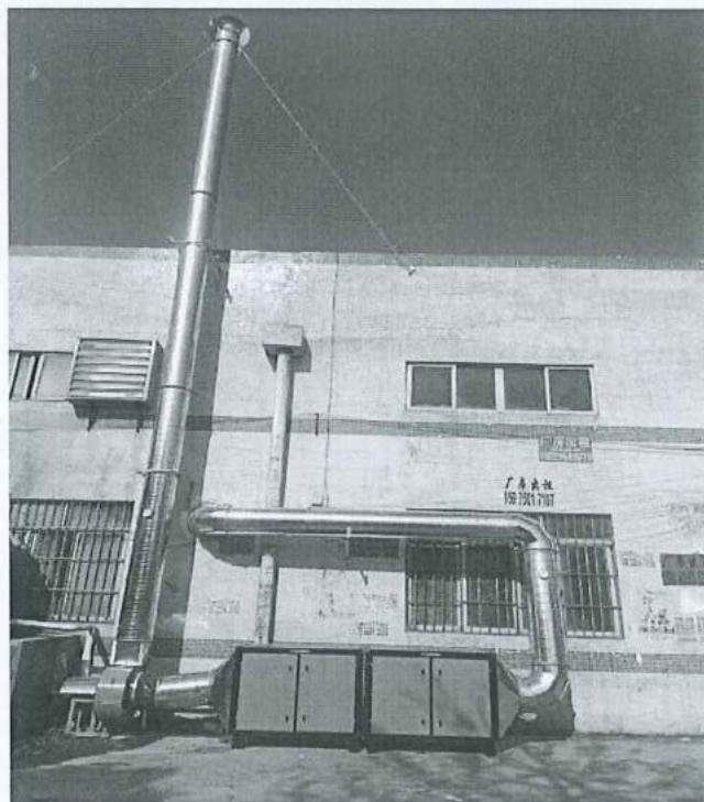
图 4.2 注塑废气治理设施图
