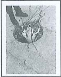
生活污水排放口
