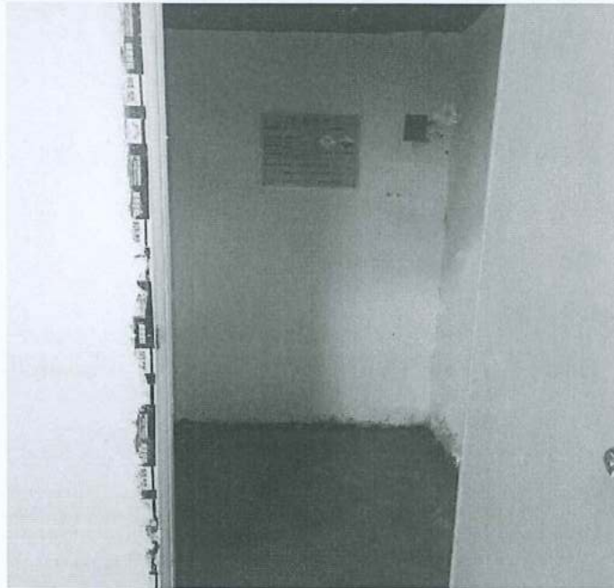
图 4.4 危废房内部图
