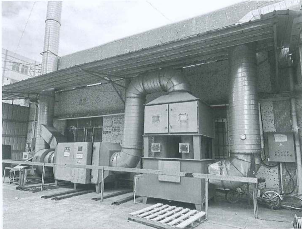
图 4.2 有机废气治理设施图
