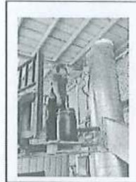
挤出、吸塑废气排放口
