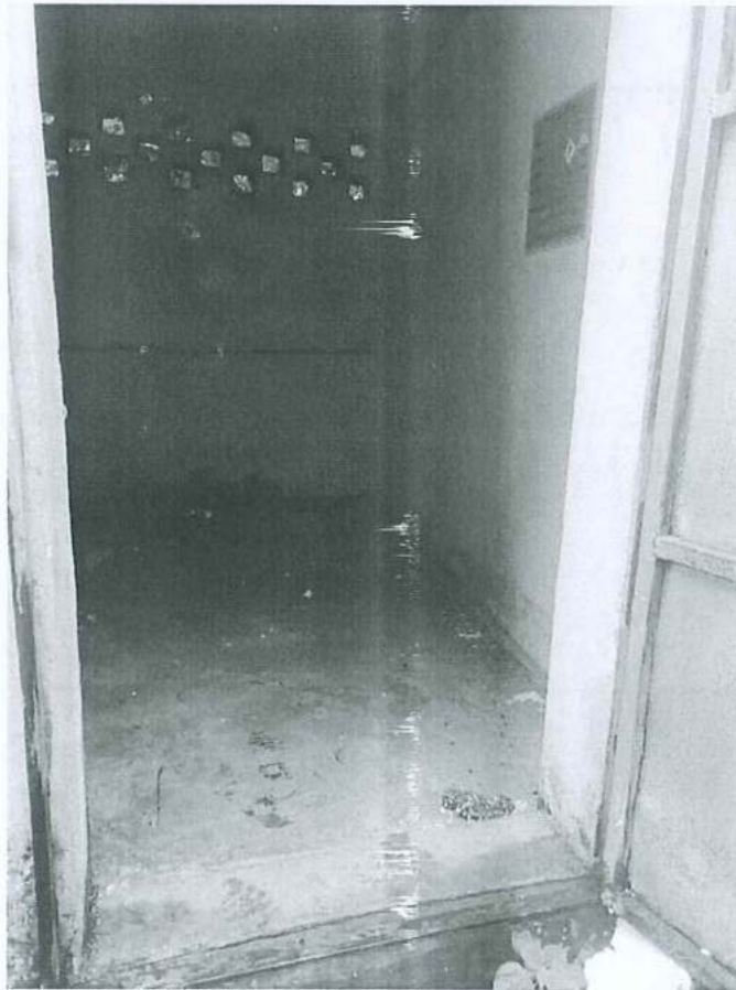
图 4.5 危废房内部图
