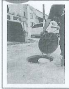
生活污水排放口
