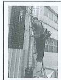
注塑废气排放口
