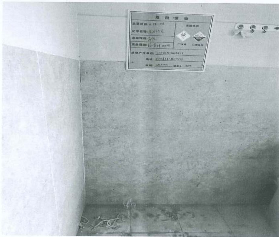
图 4.4 危废房内部图
