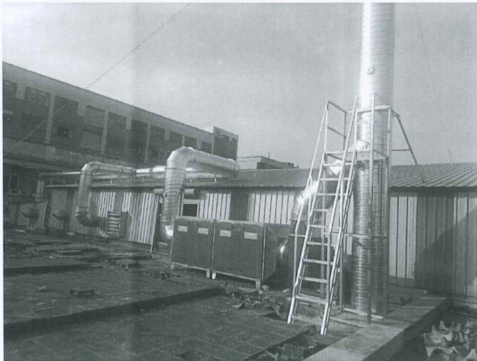
图 4-2 废气治理设施处理图
