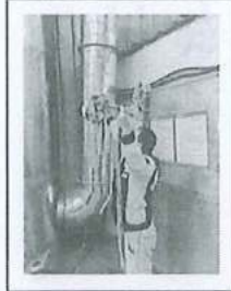
熔铝烟尘、燃烧废气处理前
