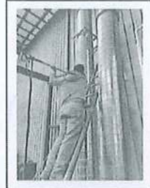
熔铝烟尘、燃烧废气排放口
