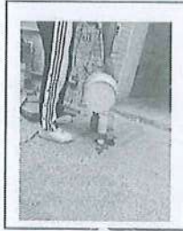
生活污水排放口
