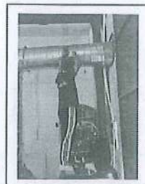
注塑废气排放口
