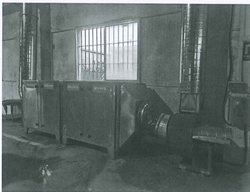
图 4.3 印刷废气治理设施图
