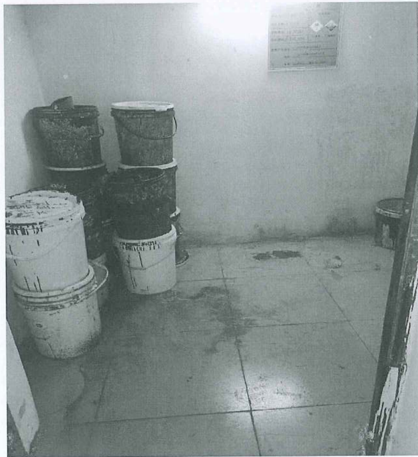
图 4-7 危废房内部图
