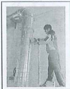
印刷废气处理前
