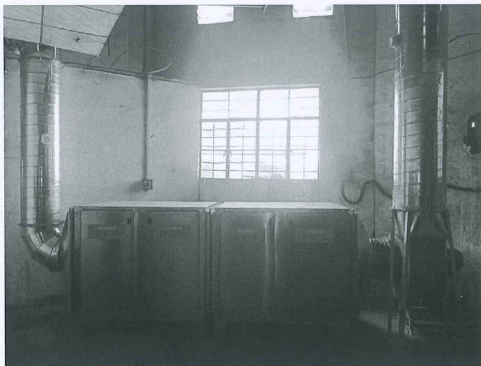
图 4.2 注塑挤出、吹膜废气治理设施图
