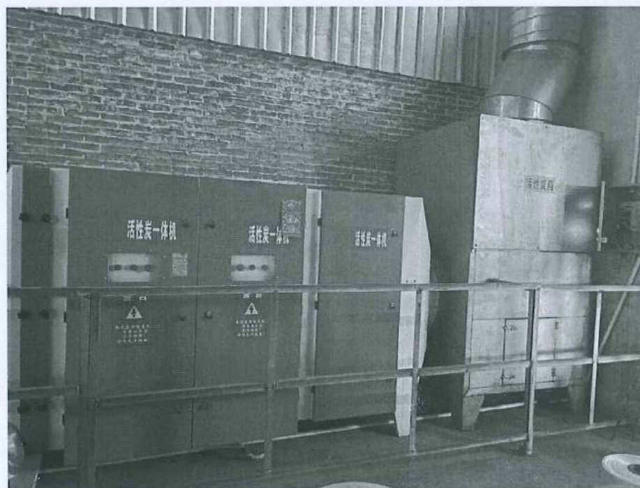
图 4.2 吹膜、印刷废气治理设施图
