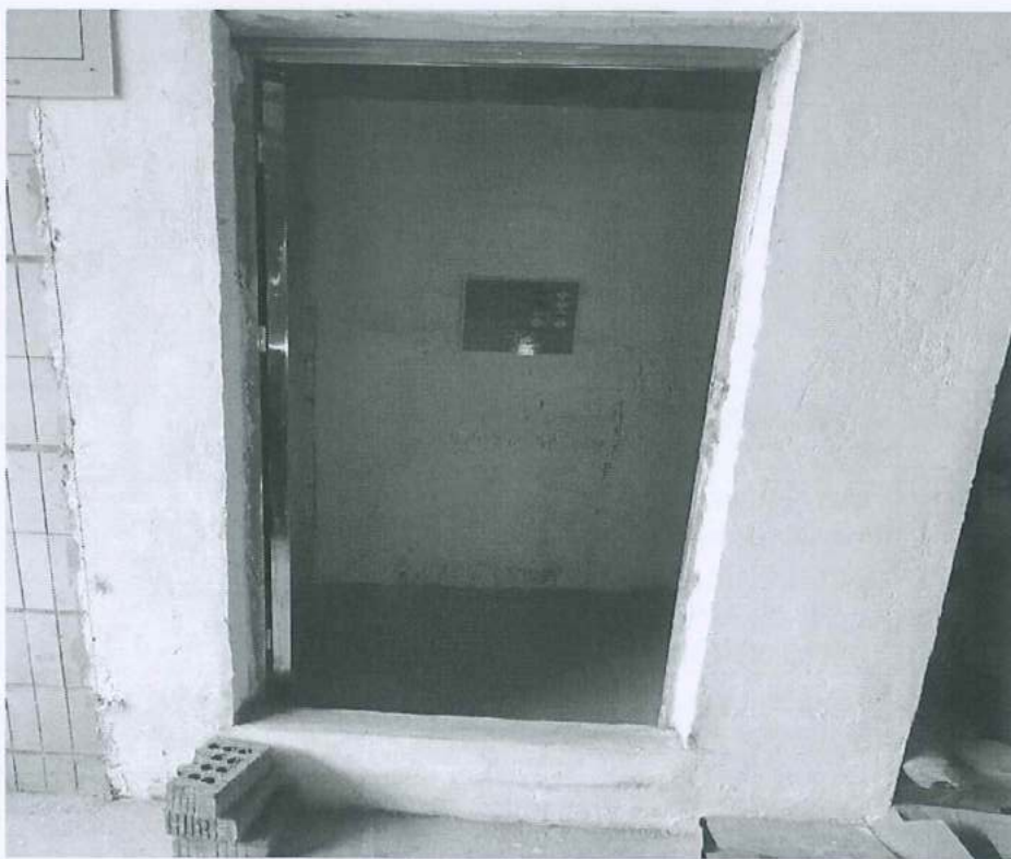
图 4.4 危废贮存仓内部图
