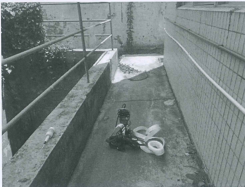
图 4-9 一期项目应急池和应急泵图
