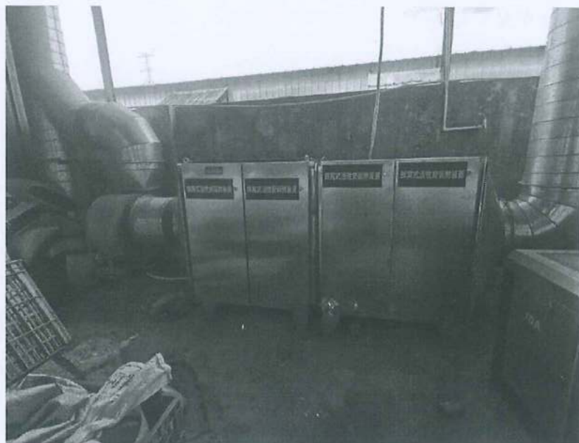
图 4-2 废气治理设施处理图
