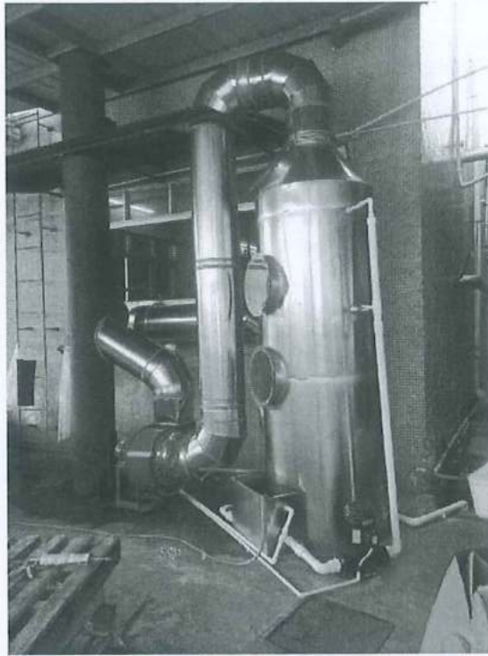
图 4-2 废气治理设施处理图
