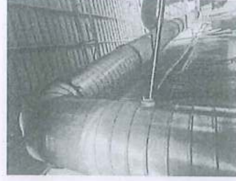
喷粉废气处理前检测口/Q3
