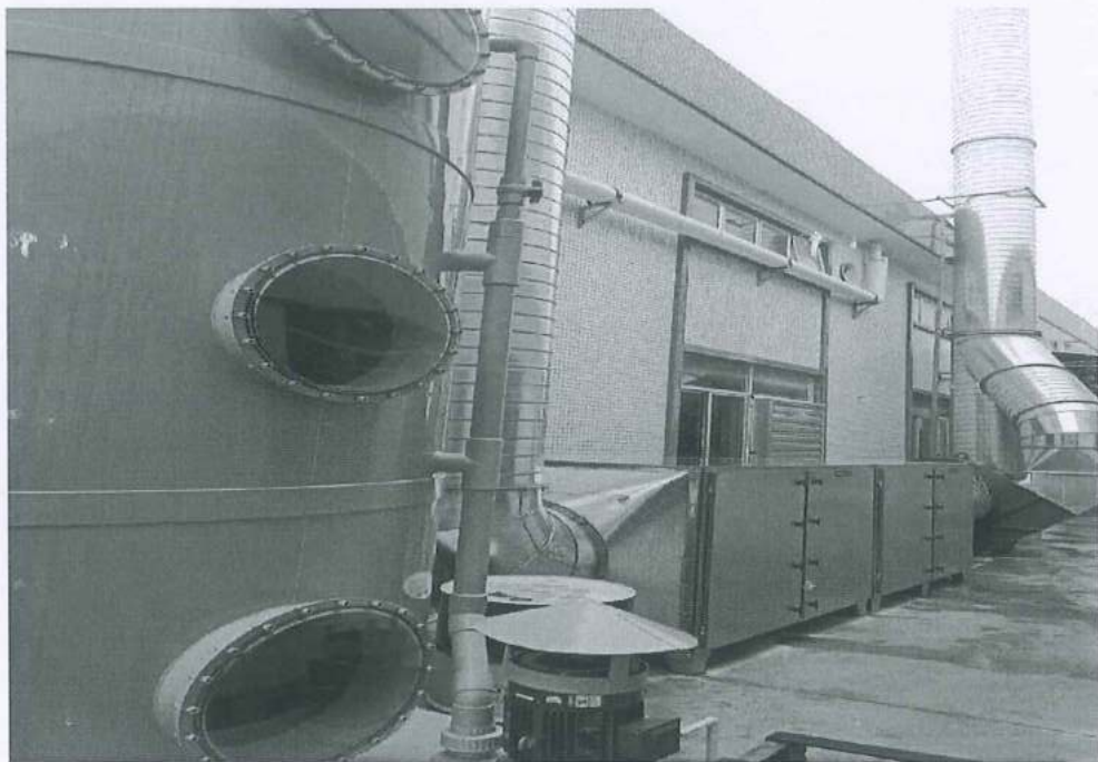
图 4-2 B 车间注塑、搪胶、喷油废气治理设施图
