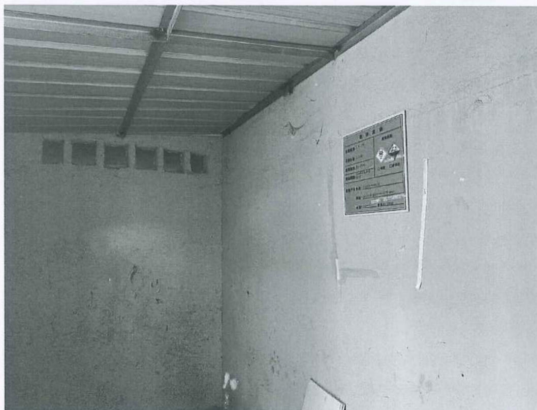
图 4-6 危废房内部图
