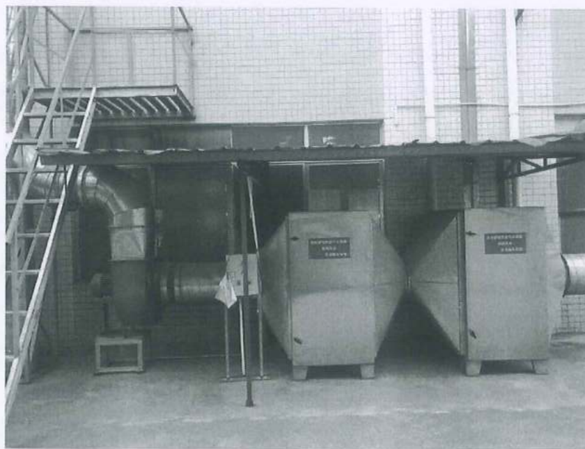
图 4.4 接条、压板废气治理设施图
