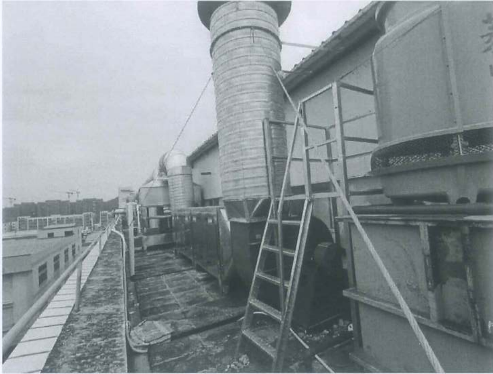
图 4.2 喷淋、浸漆废气治理设施图
