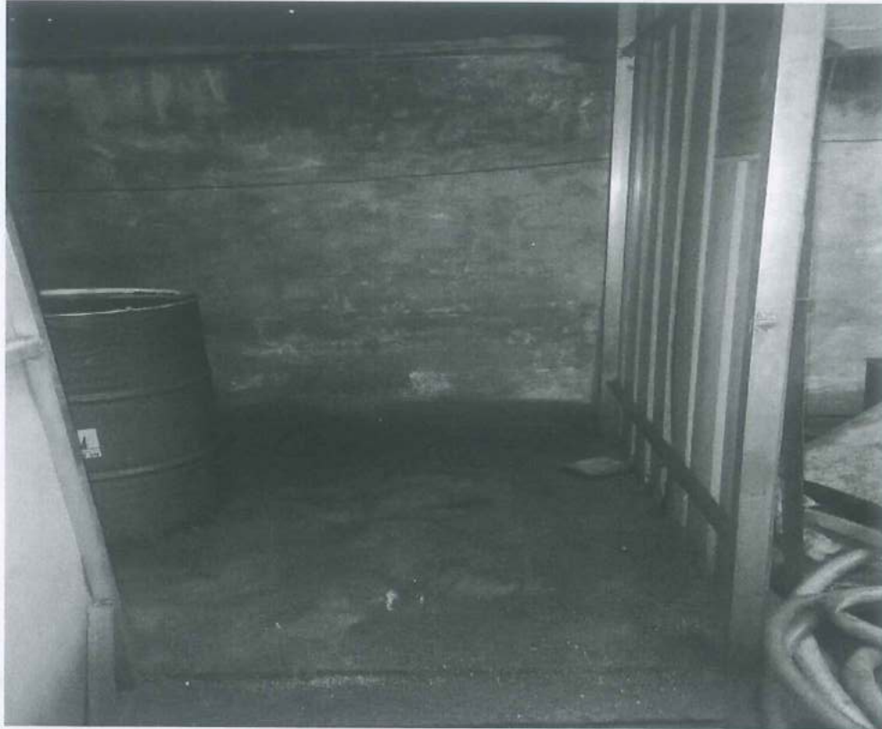
图 4.4 危废贮存仓内部图
