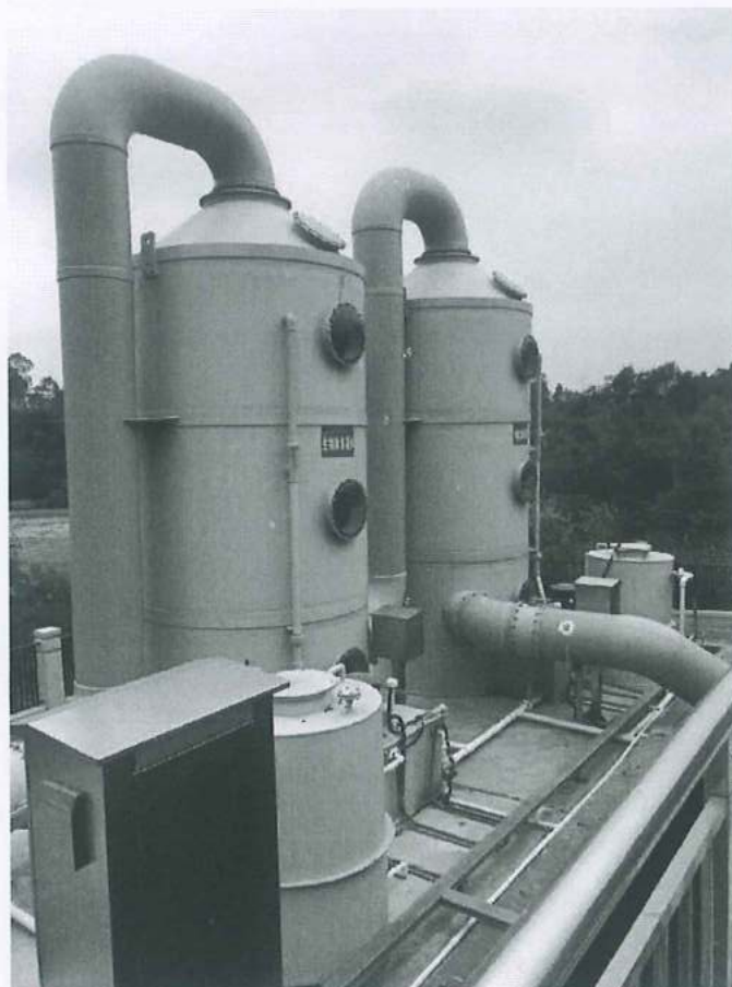
图 4.2 一期废治理设施现场情况图
