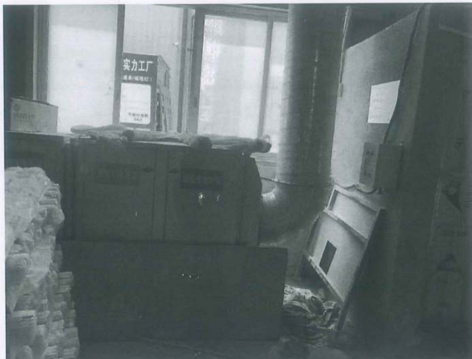
图 4.2 挤出有机废气治理设施图
