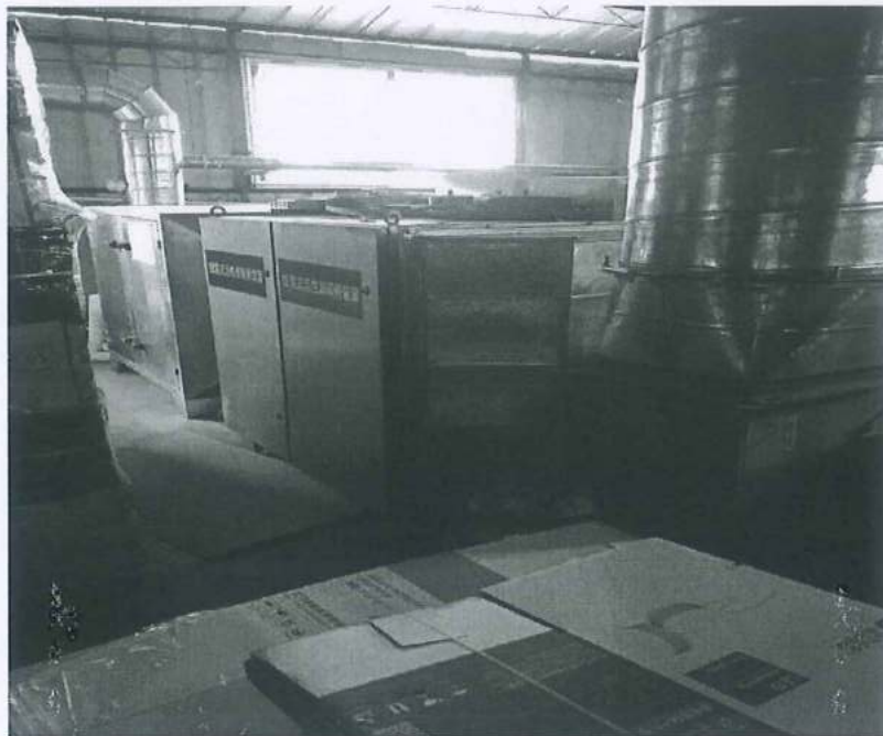
图 4-1 印刷有机废气处理设施图
