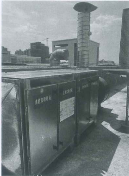
图4.1有机废气治理设施图
