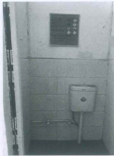
图4.3危废间内部图
