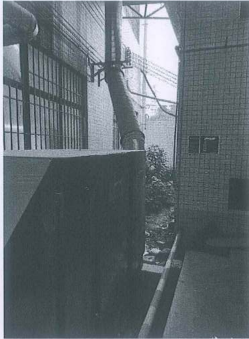
图4.1 有机废气治理设施图
