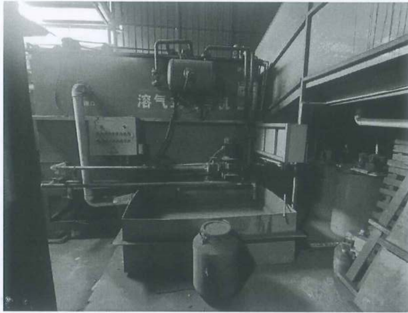
图 4.3 废水治理设施设施图
