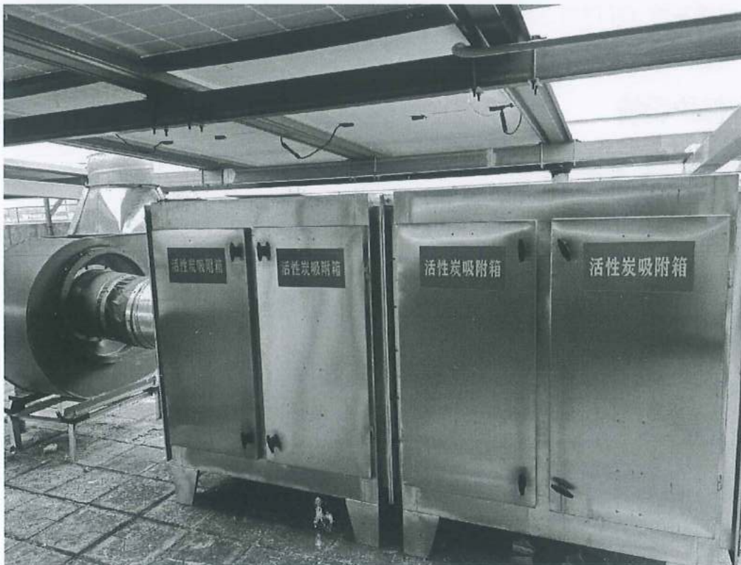
图4.1有机废气治理设施图
