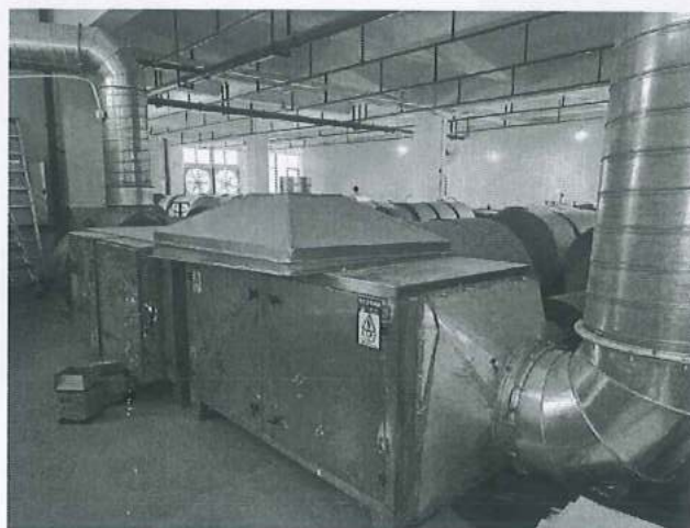
图4.3有机废气治理设施图
