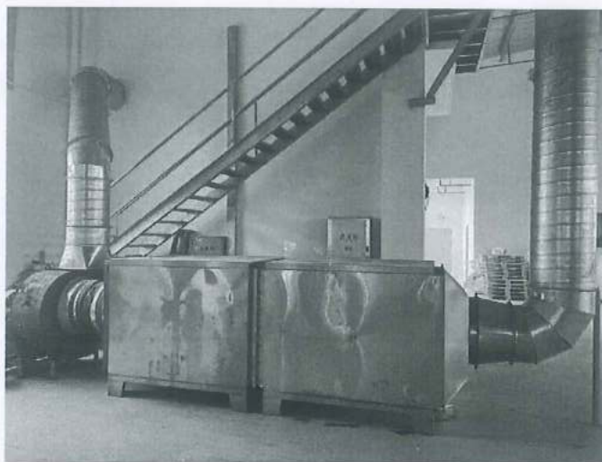
图4.2有机废气治理设施图
