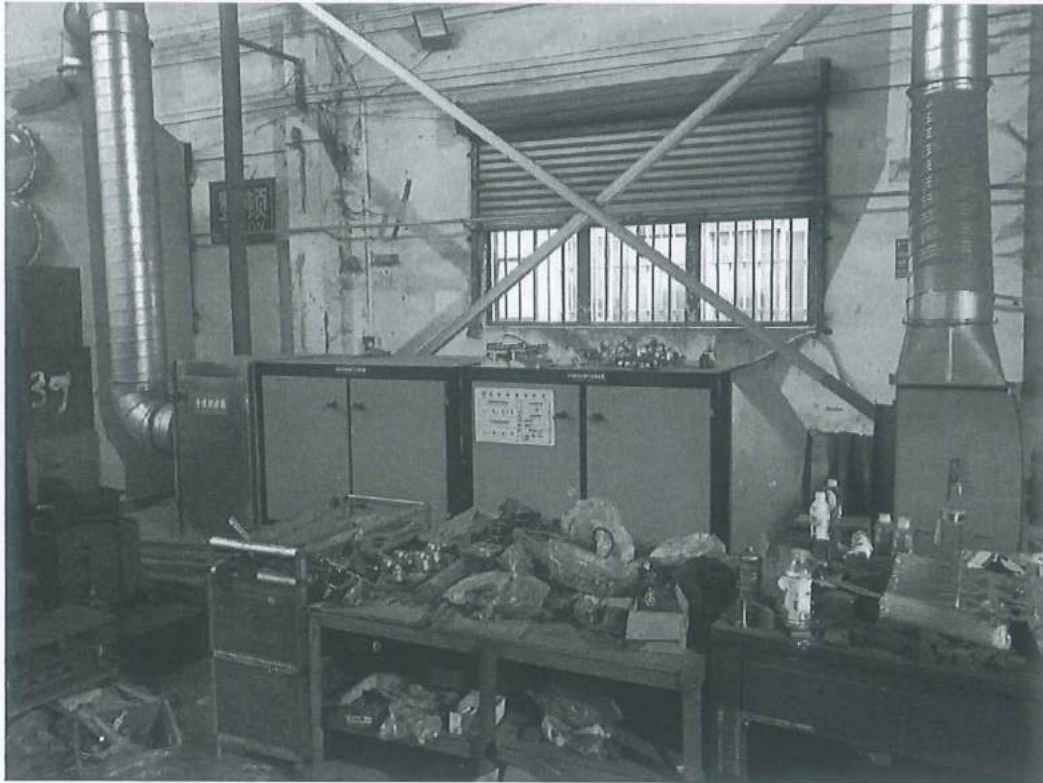
图 4.2 熔铝脱模有机废气治理设施图
