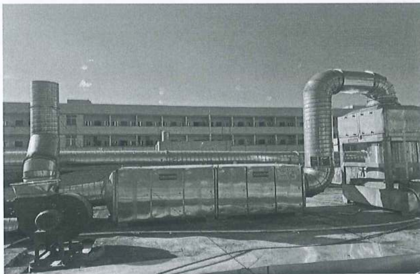
图4.1有机废气治理设施图
