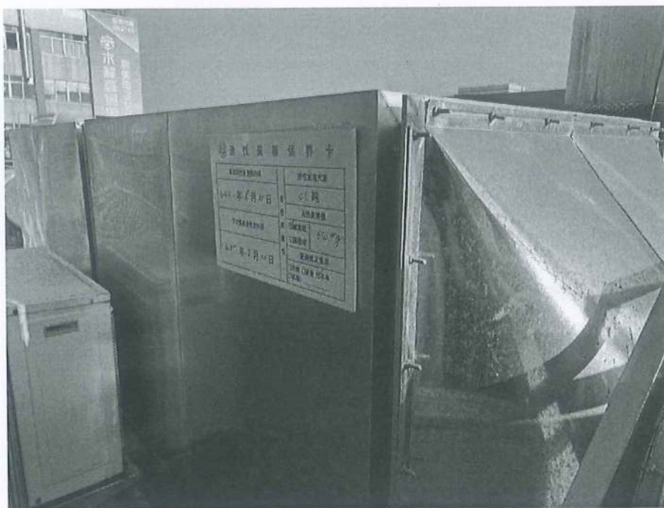
图4.1有机废气治理设施图
